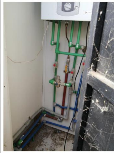
Caldera quemada y con pérdidas de agua
