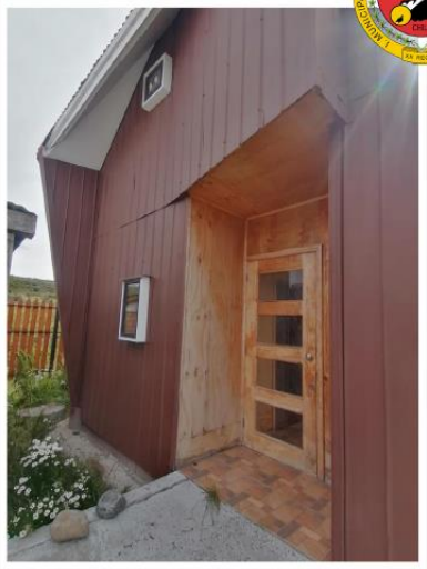
Revestimientos exteriores con mala terminación y filtraciones.
