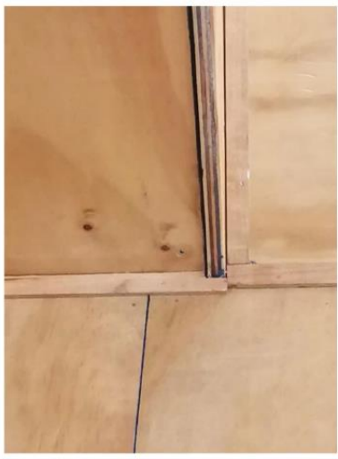
Uniones entre paneles interiores con malas terminaciones
