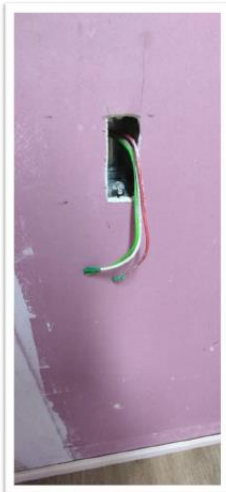
Terminaciones interiores en mal estado.
